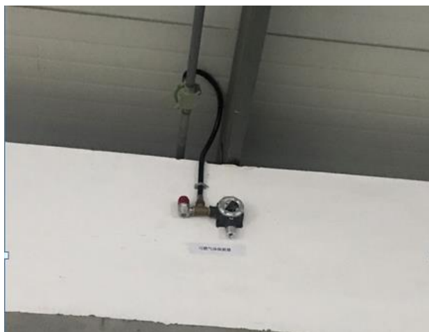
试剂库可燃气体探测器
